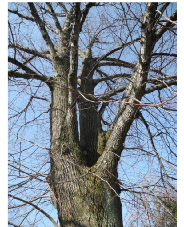
Hlavní větvení vytváří tahovou i tlakovou vidlici, je zde možný vznik dutiny.
